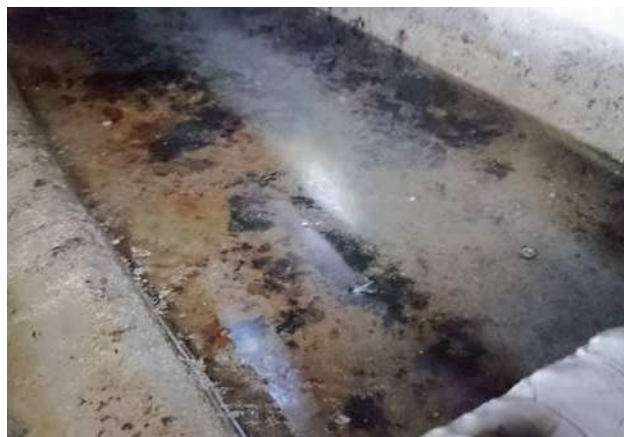
水が残って悪臭が発生する
