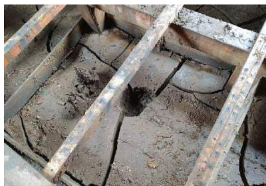
床下にたまった泥（写真③）
