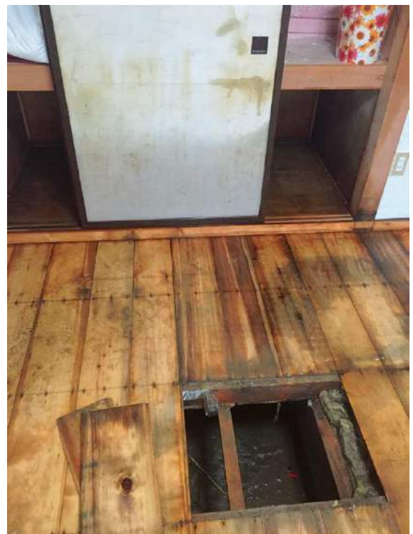
室内の被害状況も撮っておく
