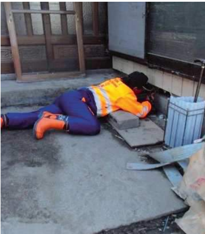
通風口から床下の泥を確認する
